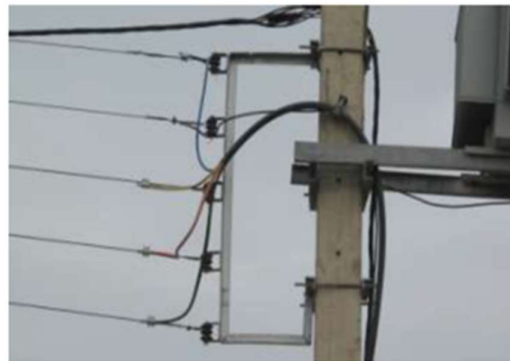
شبکه فشارضعیف هوایی
